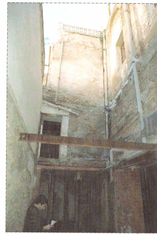
IMAGEN 07: LATERAL PATIO CON HUECOS EN PLANTA BAJA
