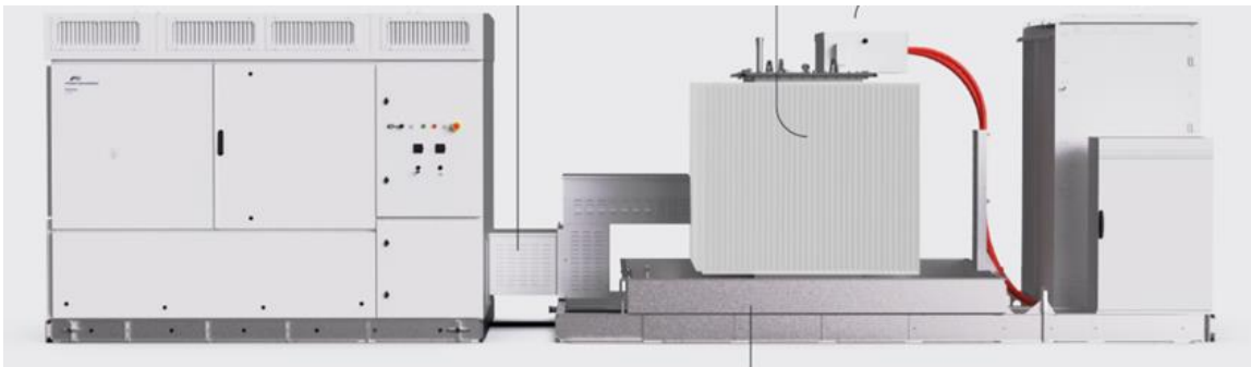
Ilustración 6: Skid de MT Power Electronics
