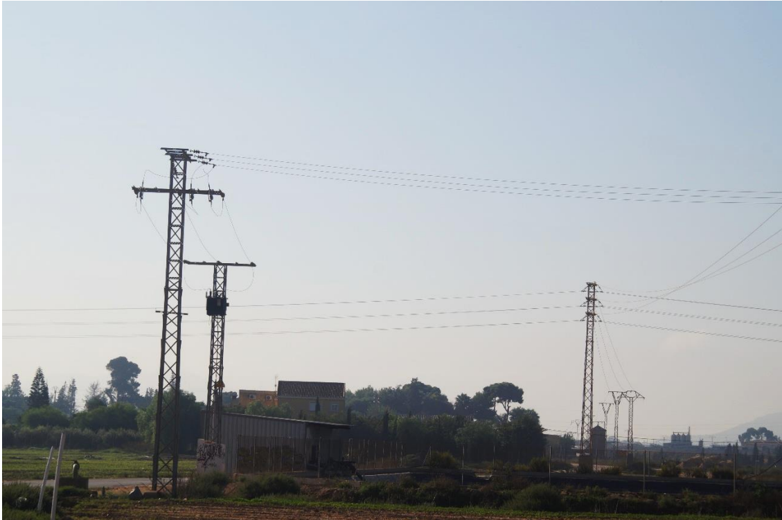
Fotografía 8. Tendidos eléctricos de media y baja tensión presentes en el ámbito de estudio
