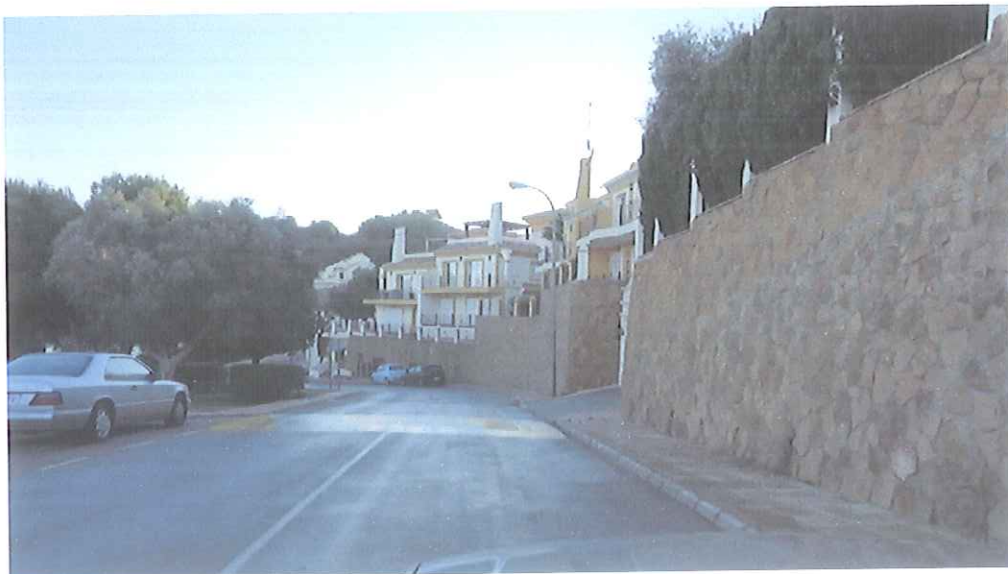
(Foto 5) Muro de cierre de 4 a 6 m de altura aproximadamente ocupando toda la longitud de la calle, prácticamente unos 300 metros.
